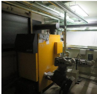
<木質チップボイラー>
